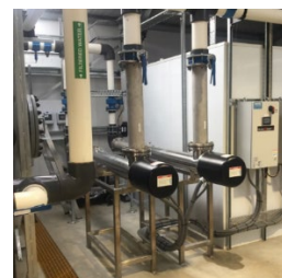
Raetihi WTP UV units
